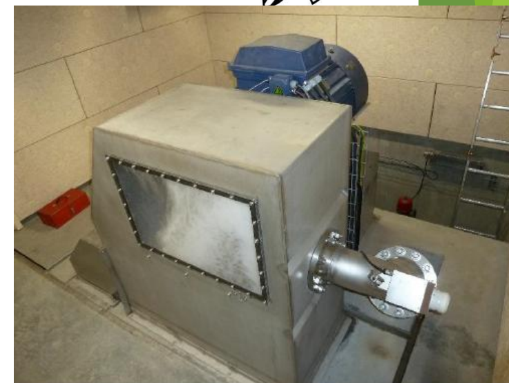
Centrale de 116kW AEP à MONETIER-LES-BAINS (05)
